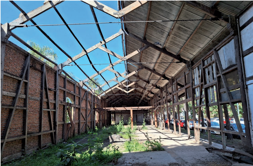
Figura 17. Depósito de cargas en ruinas, Estación Tucumán El Bajo, 2023. Foto: M. Ferrari.
